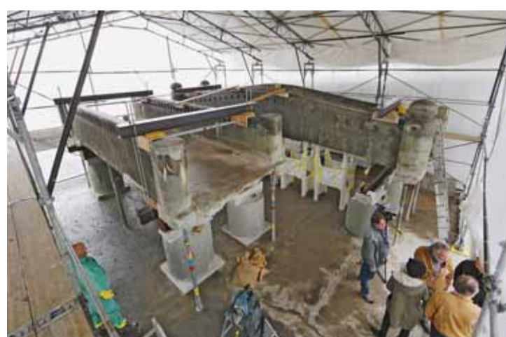
Die zwei Lysser Patienten: Die Herrngassebrücke (links) und die Mussolinibrücke werden in Bern restauriert. zvg
